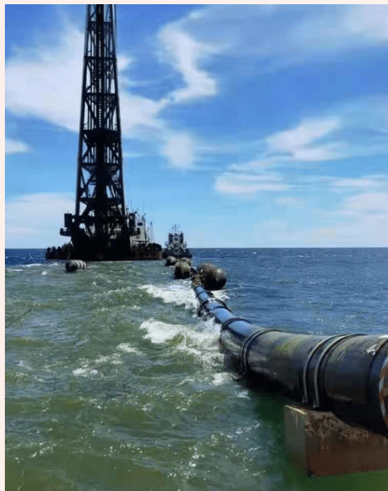
馮家灣取水工程
